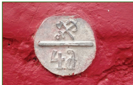
Нивелирная марка КОПС в стене Георгиевской церкви, Корёга
